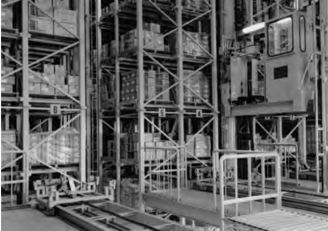
Sistema di magazzino automatico
