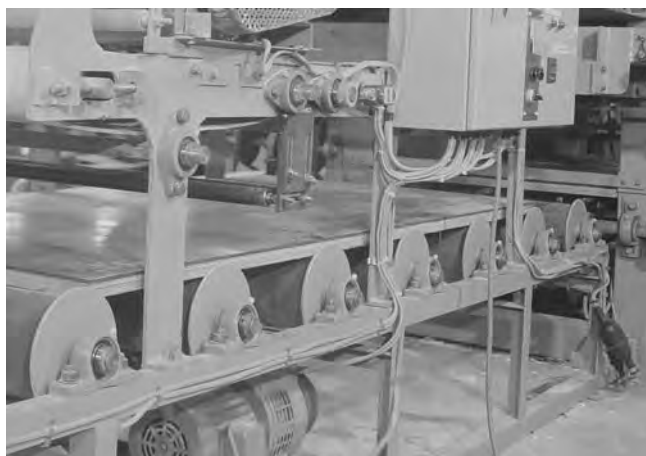
Sistema di alimentazione
